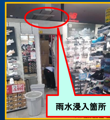
雨水浸入状況
